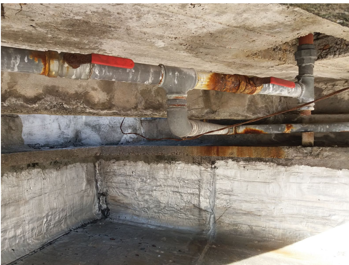
Salida de tanques superiores existente (a sustituir)
