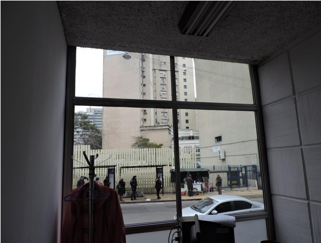
FOTO 3 (infiltraciones en cerramiento de aluminio en planta baja)
