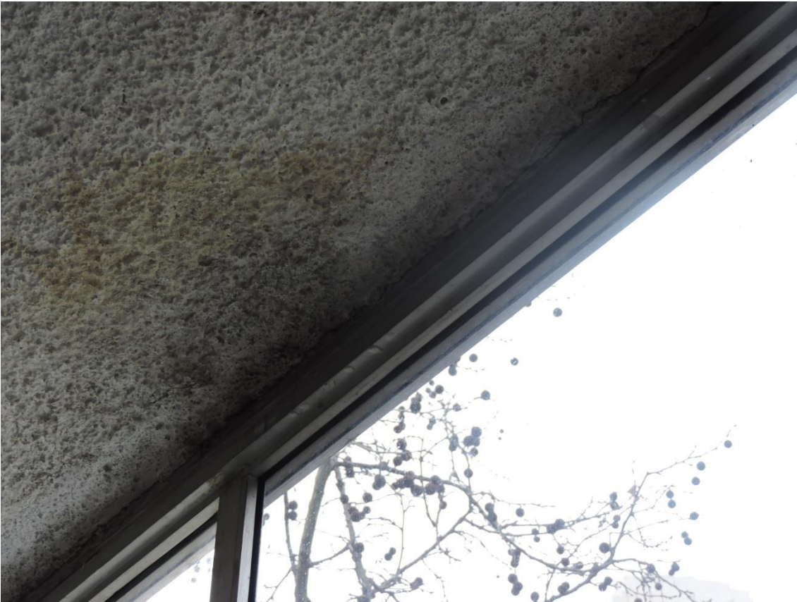
FOTO 1 (infiltraciones en cerramiento de aluminio en segundo piso)
