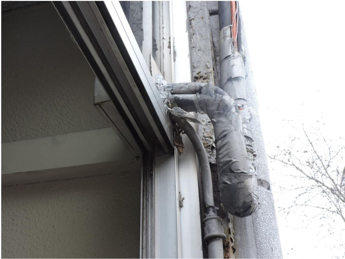
FOTO 2 (infiltraciones en cerramiento de aluminio en primer piso)
