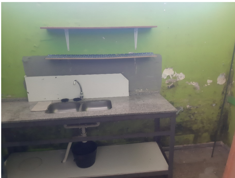
Figura 02. Detalle de instalación actual de pileta de cocina
