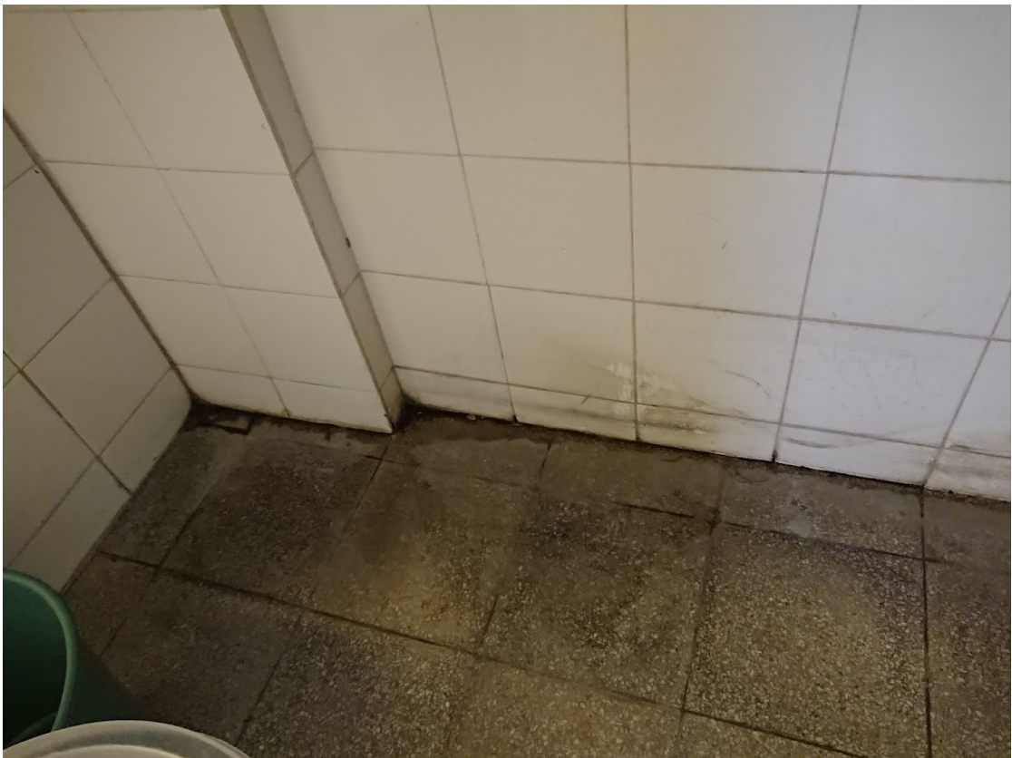
Filtraciones existentes en nivel superior (sector bajo mesada en SSHH)
