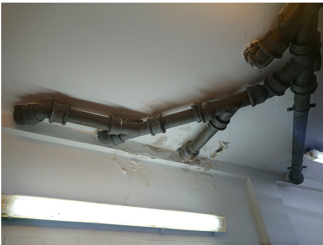
Filtraciones existentes en nivel inferior
