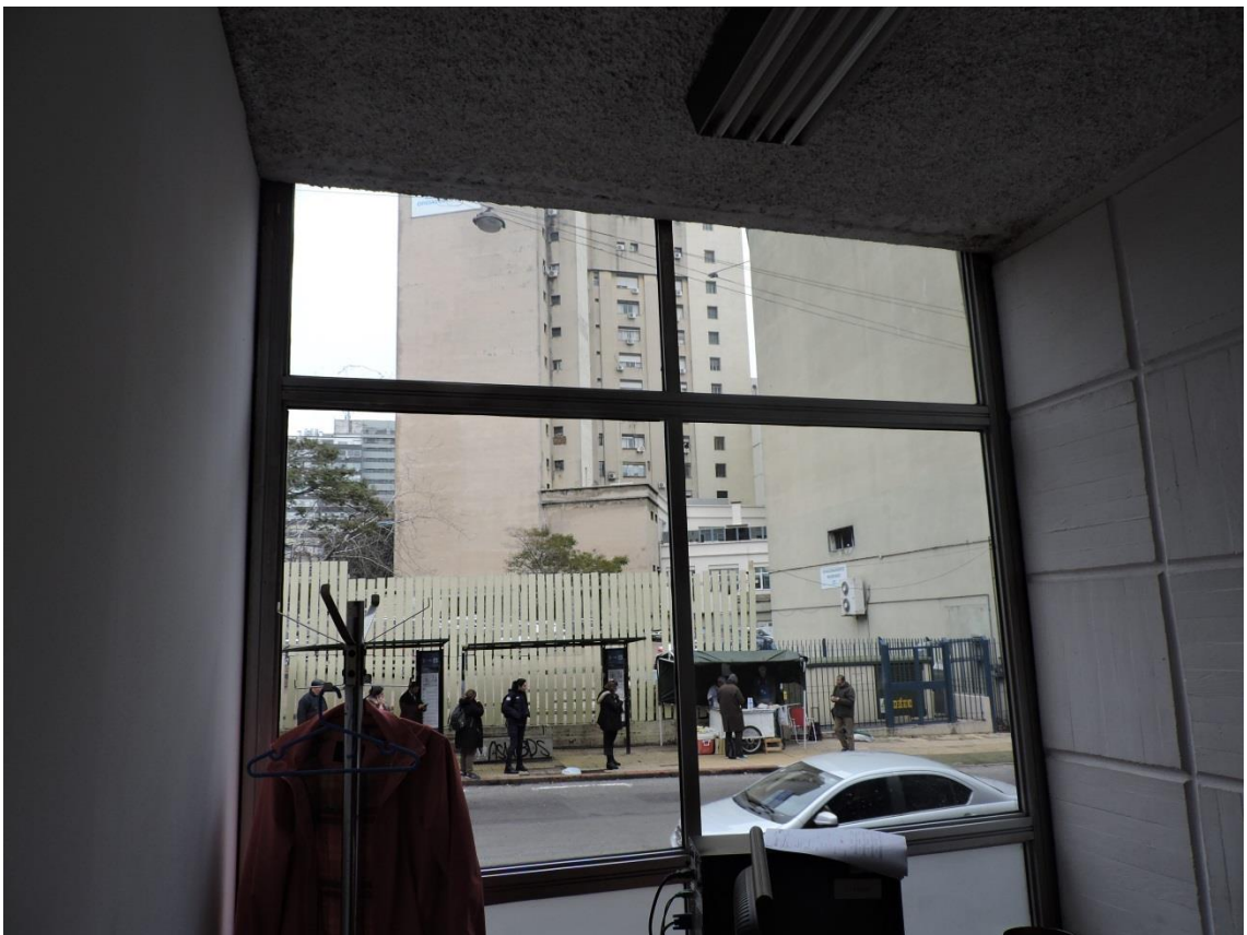
FOTO 5 (infiltraciones en cerramiento de aluminio)
