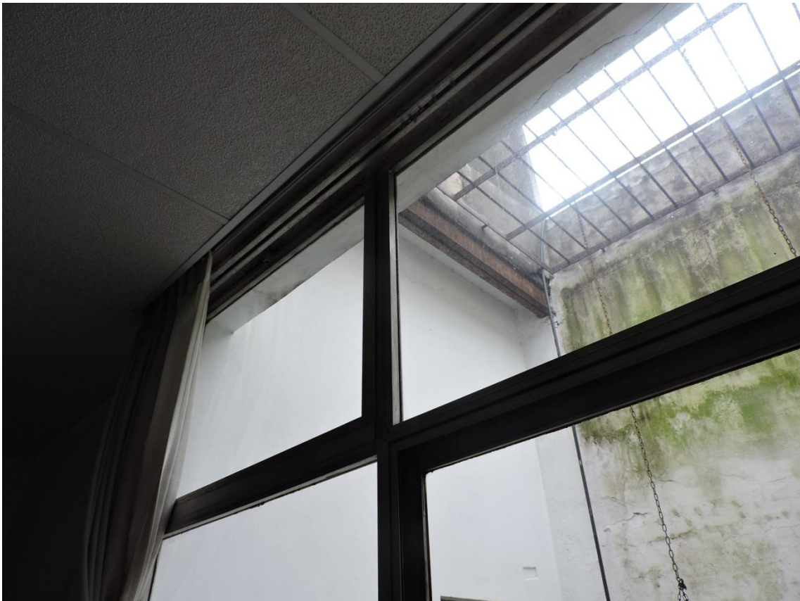
FOTO 2 (infiltraciones en cerramiento de aluminio)
