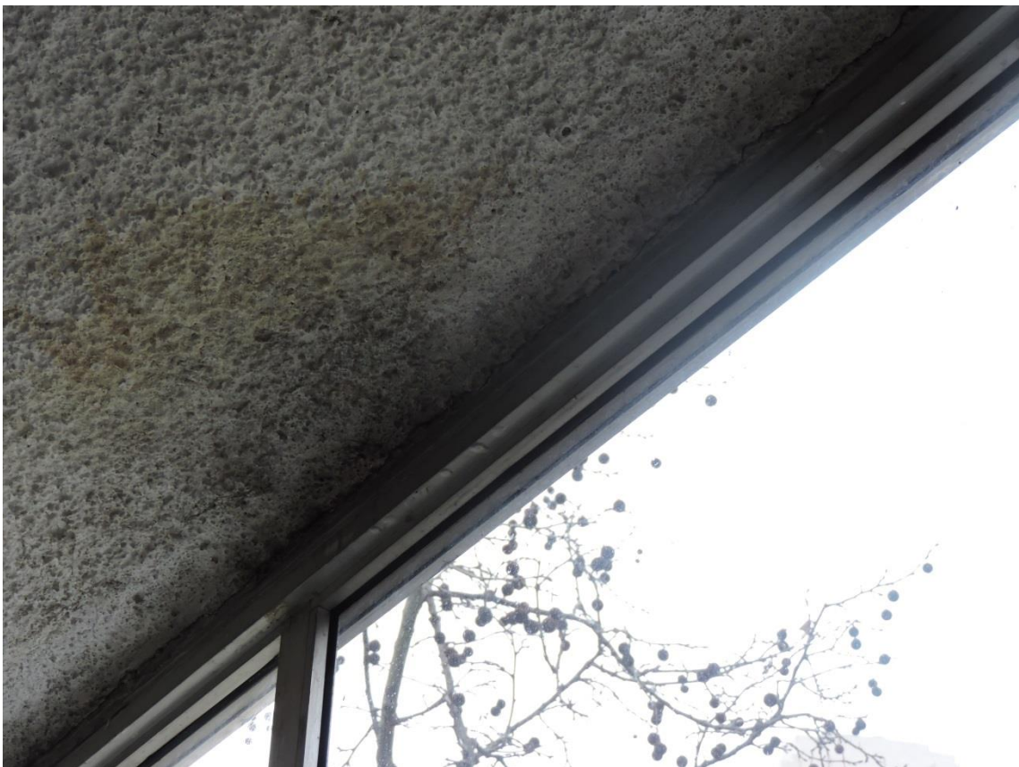
FOTO 3 (infiltraciones en cerramiento de aluminio)
