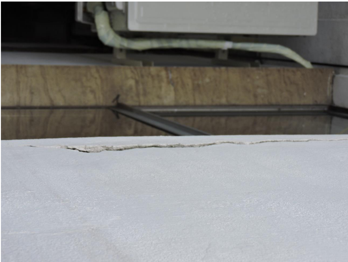
FOTO 1 (fisura en dintel)
