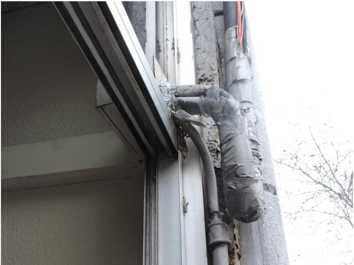
FOTO 4 (infiltraciones en cerramiento de aluminio)
