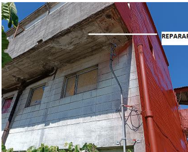
TERRAZA DE UNIDAD SUPERIOR, REPARAR
