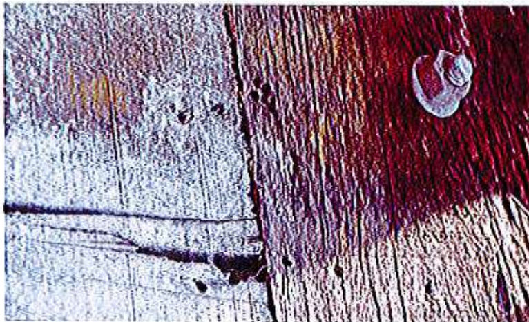
Figura A6. Ataque de insectos en pilar y viga de Pórtico.
