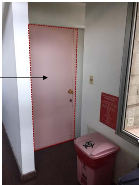
Puerta 4 a retirar (depósito). Se sustituirá por puerta 3.
