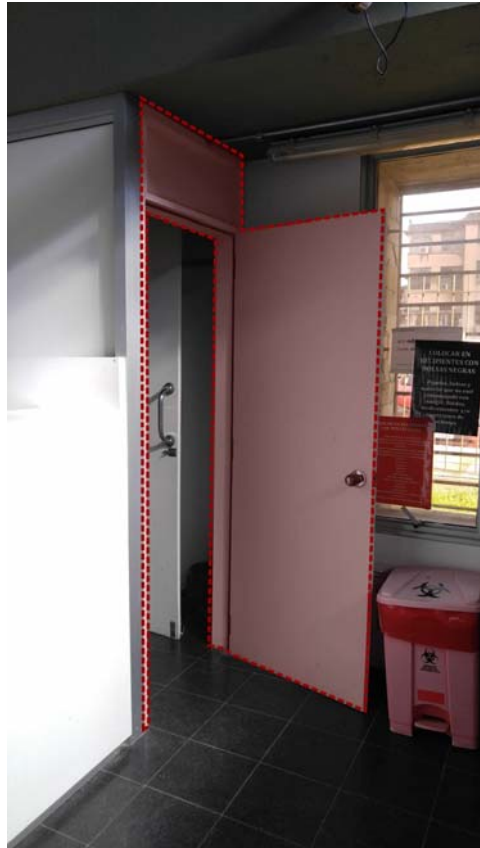
Puerta 2 a retirar (sala revelados)
