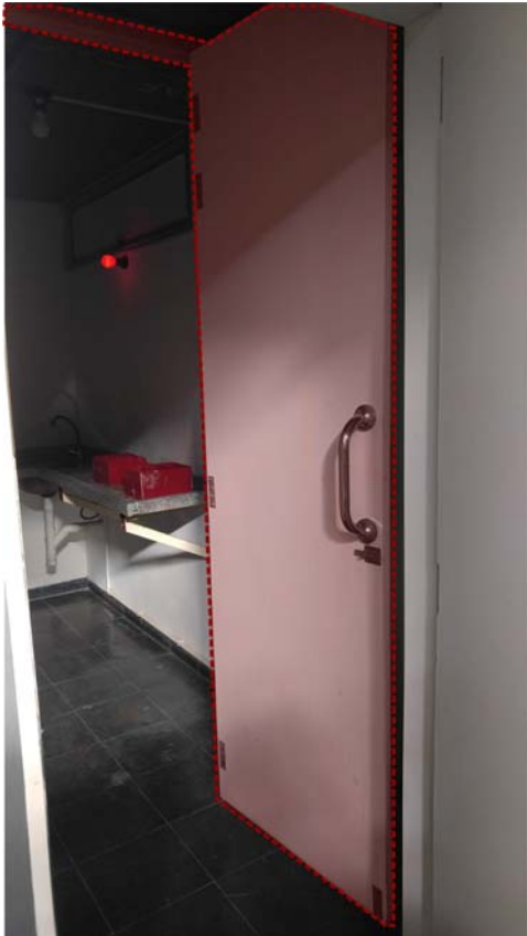
Puerta 1 a retirar (sala revelados)
