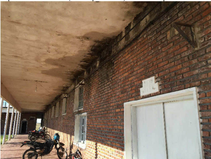
Humedad en cubierta.
