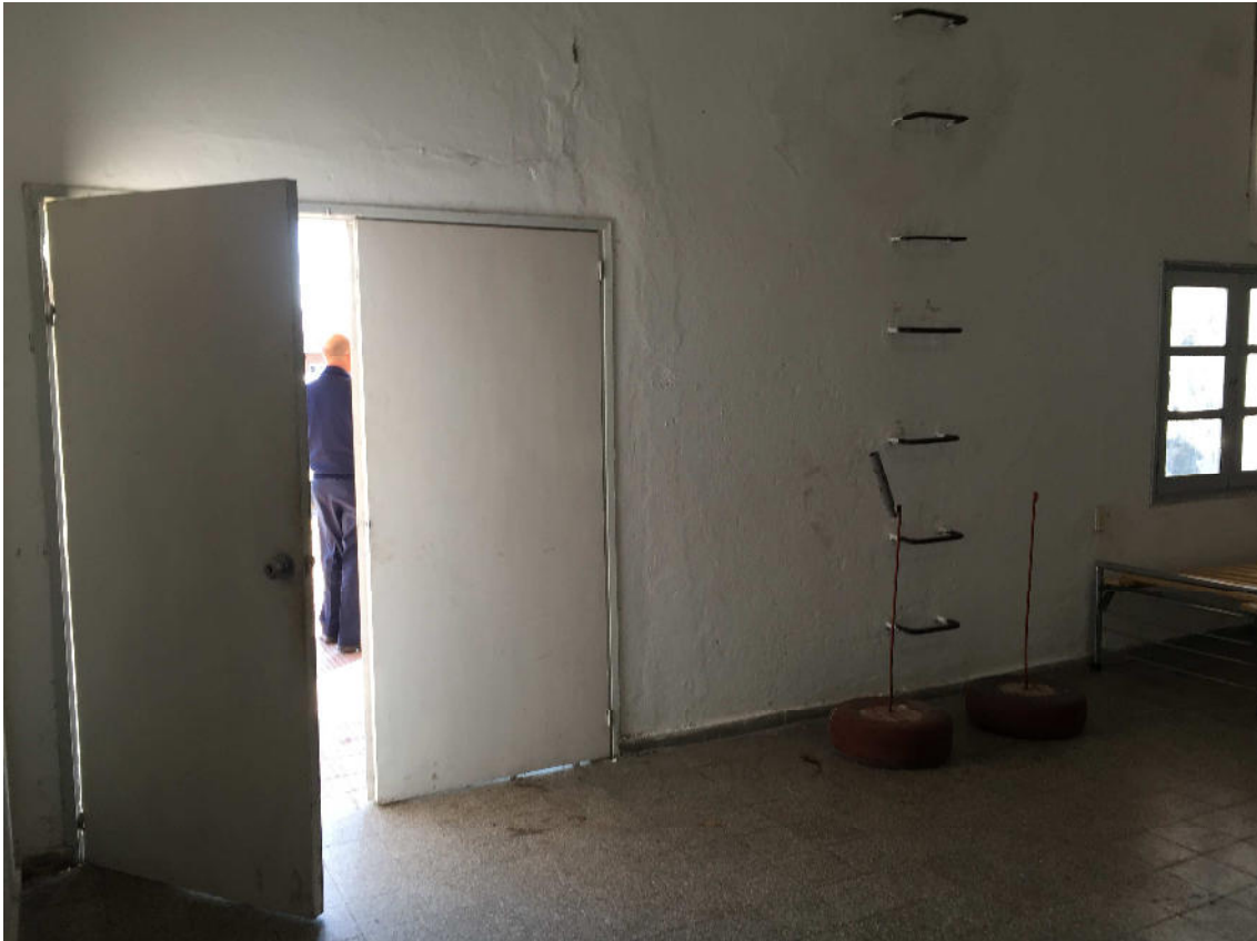
Puerta de acceso a local 2. Retirar y utilizar las hojas en la puerta de acceso al comedor.
