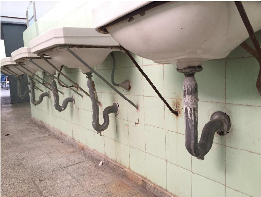
Soportes de lavamanos.
