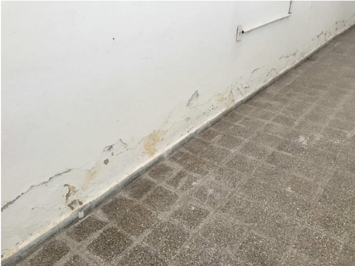
Rajaduras a reparar.
