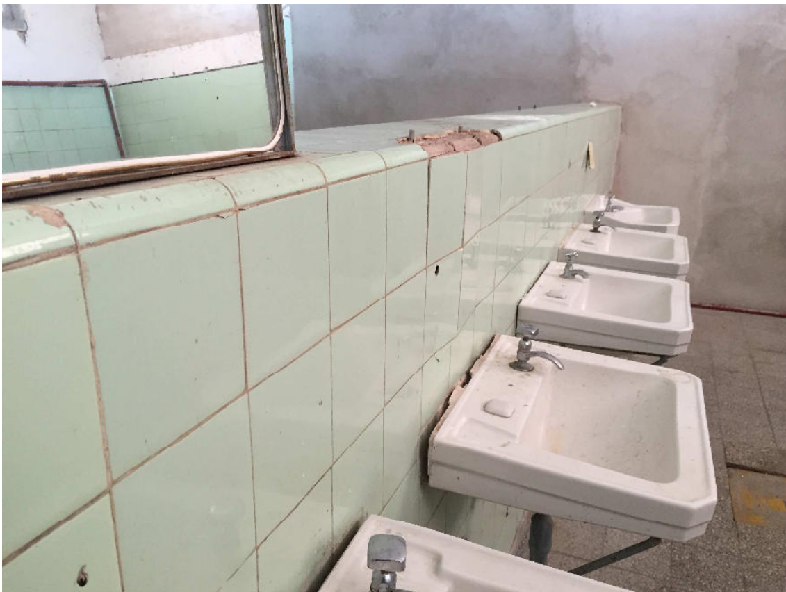
Cerámicos sueltos en muro intermedio.
