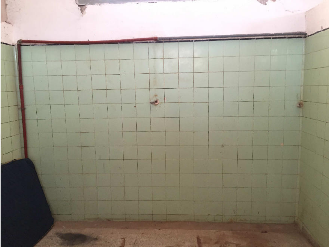
Línea de abastecimiento existente.
