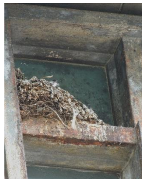
IMG 10. Nido y guano de aves. Oxidación en la perfilería del ventanal.
