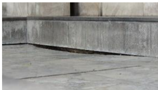
IMG 08. Hundimiento de pavimento en galería.
