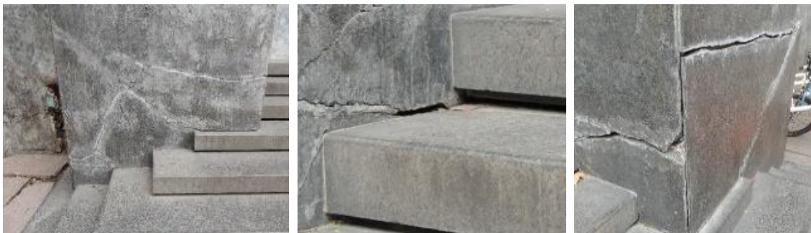
IMG 05 – 06 – 07. Grietas y fracturas las bases de las esculturas. Hundimiento de escalones.
