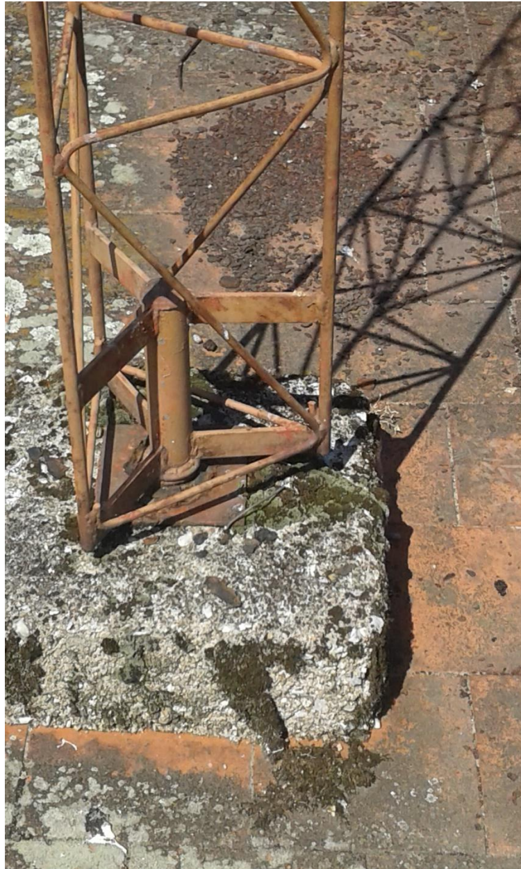
Foto N°2 – Vista de la base de fijación de la antena
