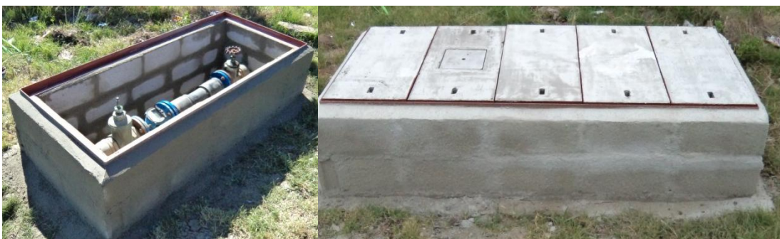
Ejemplos de nichos ya existentes para medidores \geq 3"
