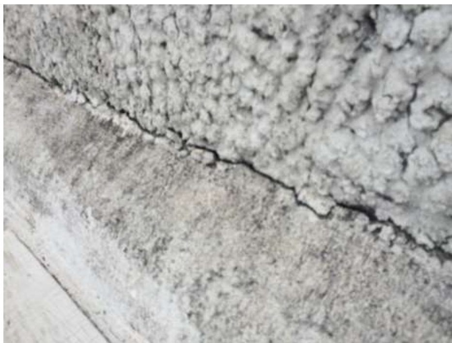
FISURA EN LINDERO SUR
