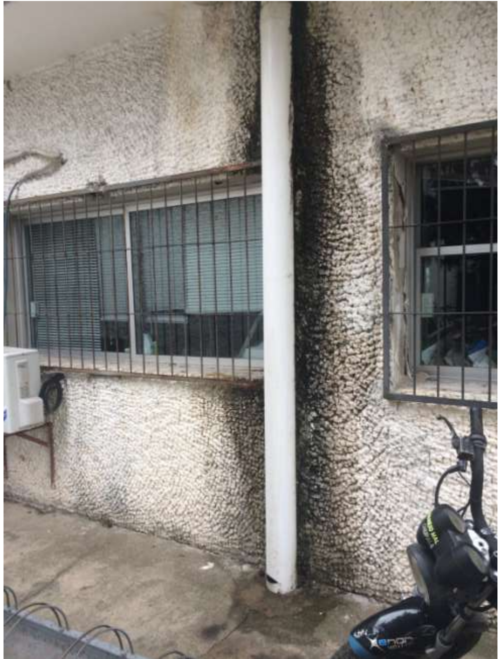
SALIDA DE PLUVIALES POR FUERA DEL DUCTO DE BAJADA
