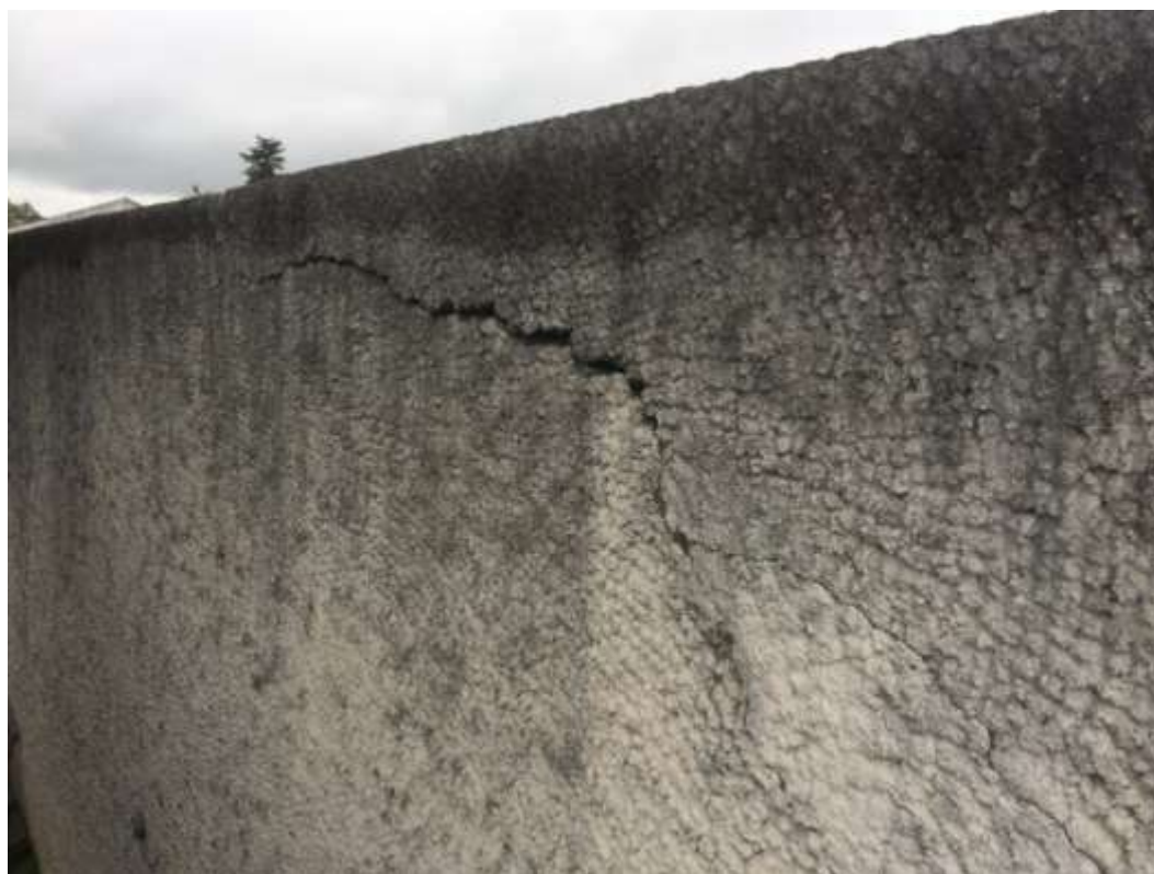
FISURA EN LINDERO SUR.
