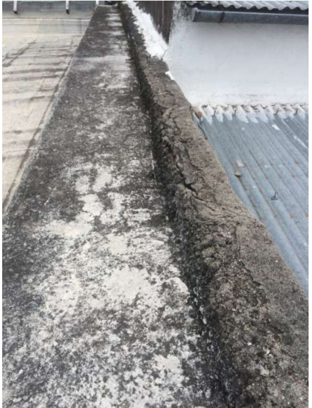
FISURA LINDERO NORTE
