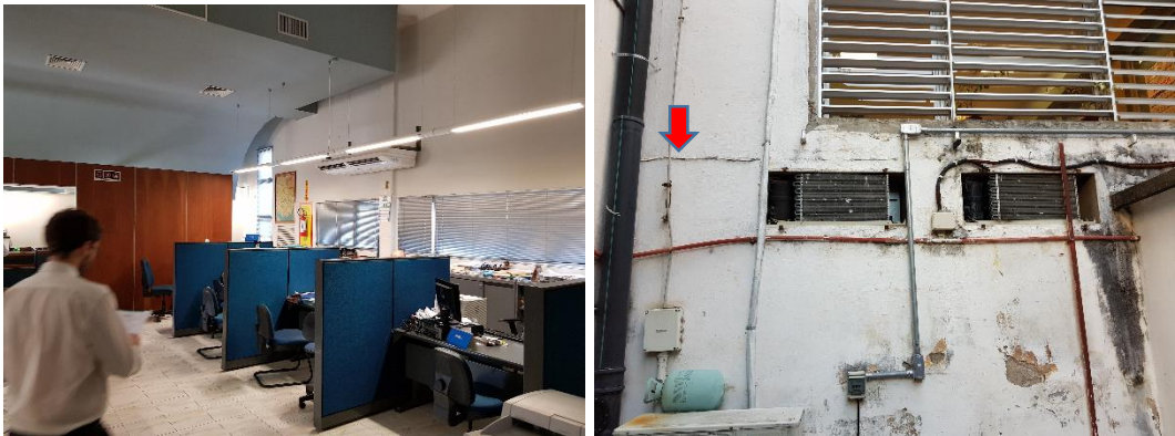
Splits y equipos a retirar
