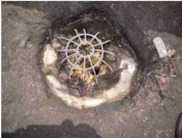
Desagüe diámetro disminuido por transporte de material calcáreo
