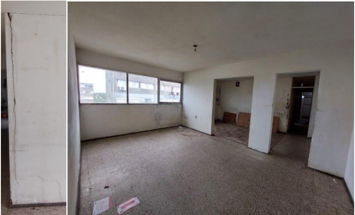
FISURA PARED ESTAR-COCINA
