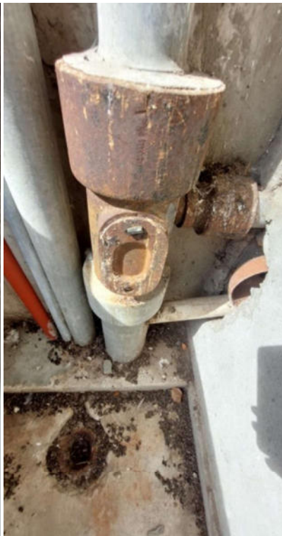
DOBLE CONEXIÓN MAL HECHA
