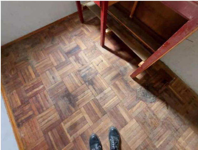
DETALLES DE PISO CON MARCAS Y MANCHAS
