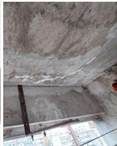
POSIBLE FILTRACIÓN DE AZOTEA
