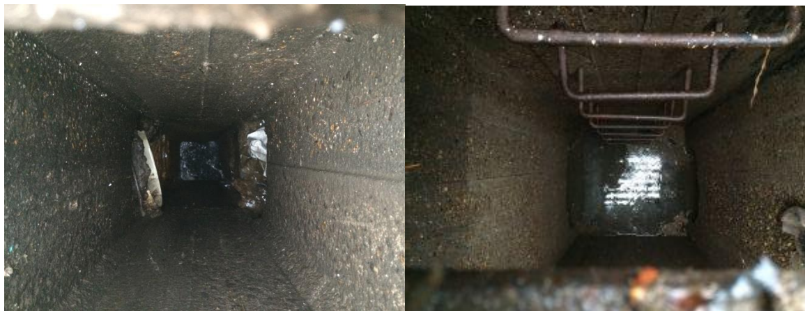
Cámara en colector pluvial interior al predio por calle prolongación L. Gómez. Conexión de desagüe de techos
