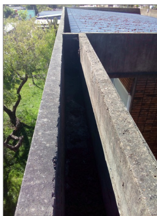
FOTO 8 – Pretil doble horm.arm. A rellenar e impermeabilizar.
