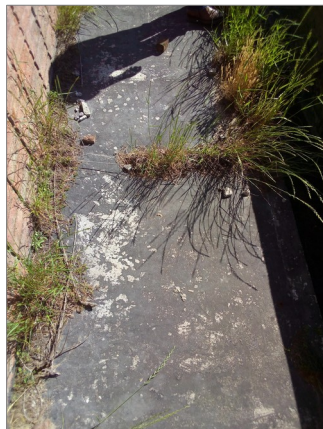
FOTO 7 – Azotea no transitable a impermeabilizar y completar pretiles.
