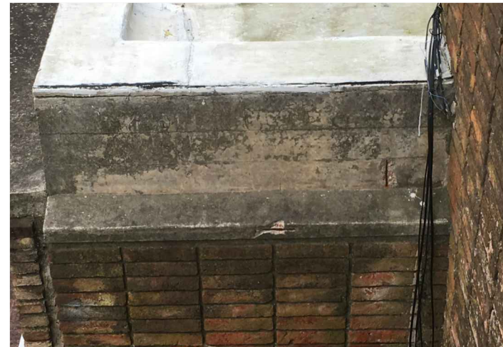
FOTO S1.09: ARMADURAS EXPUESTAS EN HORMIGÓN VISTO DE FACHADA
