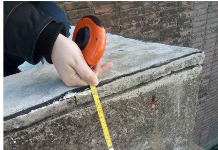
FOTO S1.08: FISURA HORIZONTAL EN PRETEL
