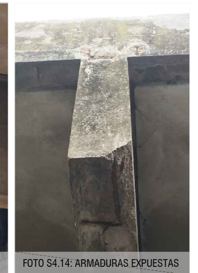
FOTO S4.13: ARMADURAS EXPUESTAS
