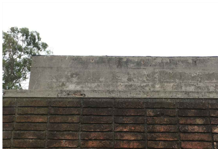
FOTO S1.11: ARMADURAS EXPUESTAS EN HORMIGÓN VISTO DE FACHADA
