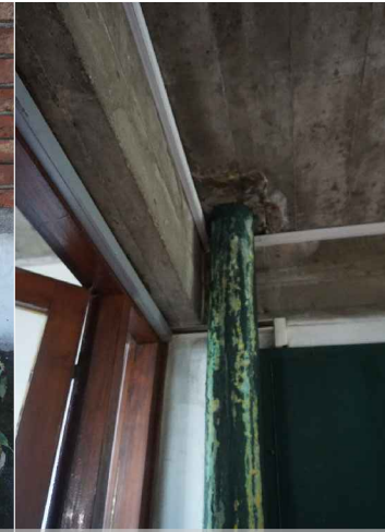
FOTO S1.04: COLUMNA DE BAJADA S1.2
