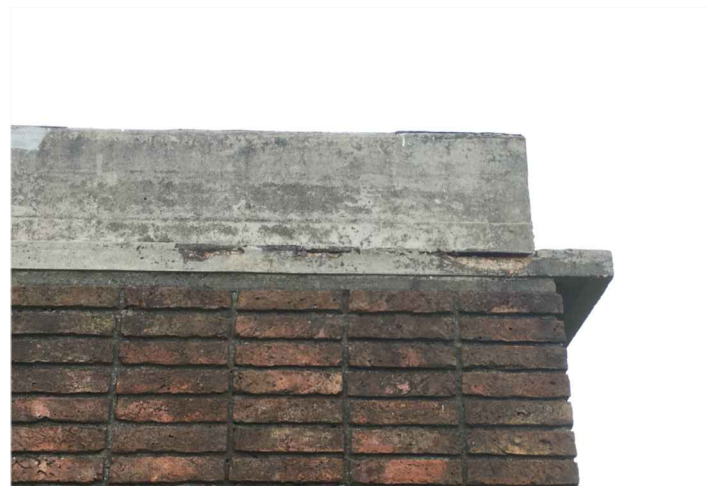
FOTO S1.12: ARMADURAS EXPUESTAS EN HORMIGÓN VISTO DE FACHADA
