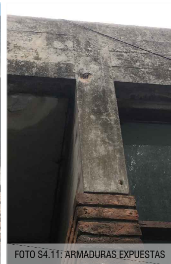
FOTO S4.10: ARMADURAS EXPUESTAS
