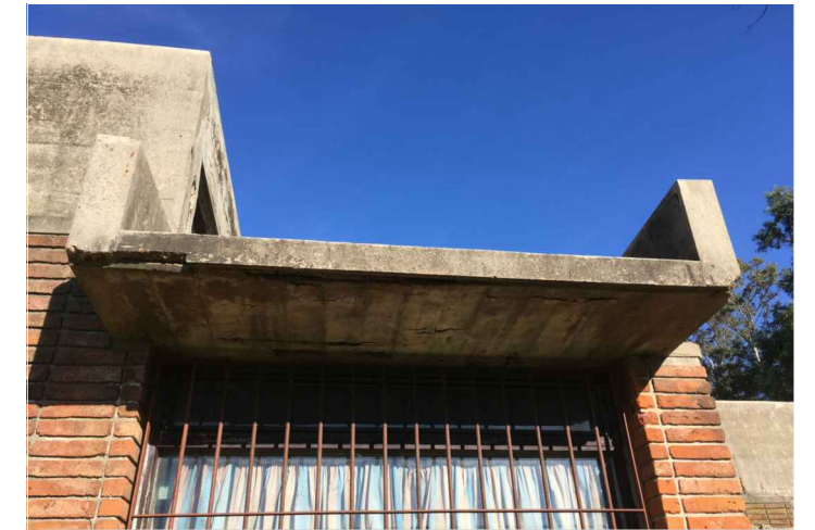
FOTO S3.04: ARMADURAS EXPUESTAS EN HORMIGÓN VISTO DE FACHADA
