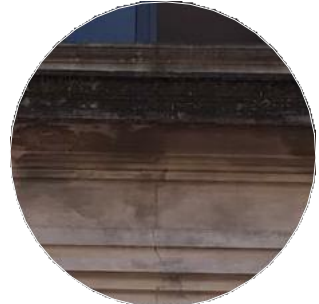
D03 Detalle fisura en cornisa inferior
